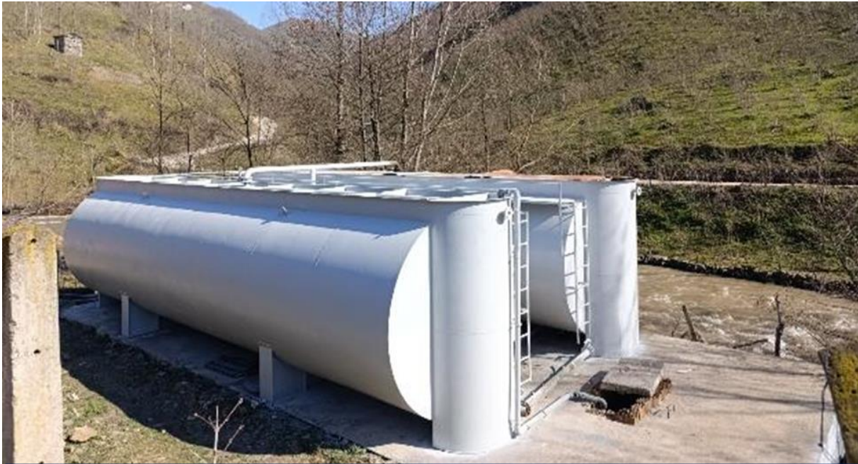
Korgan/Çiftlik Paket Atık Su Arıtma Tesis
