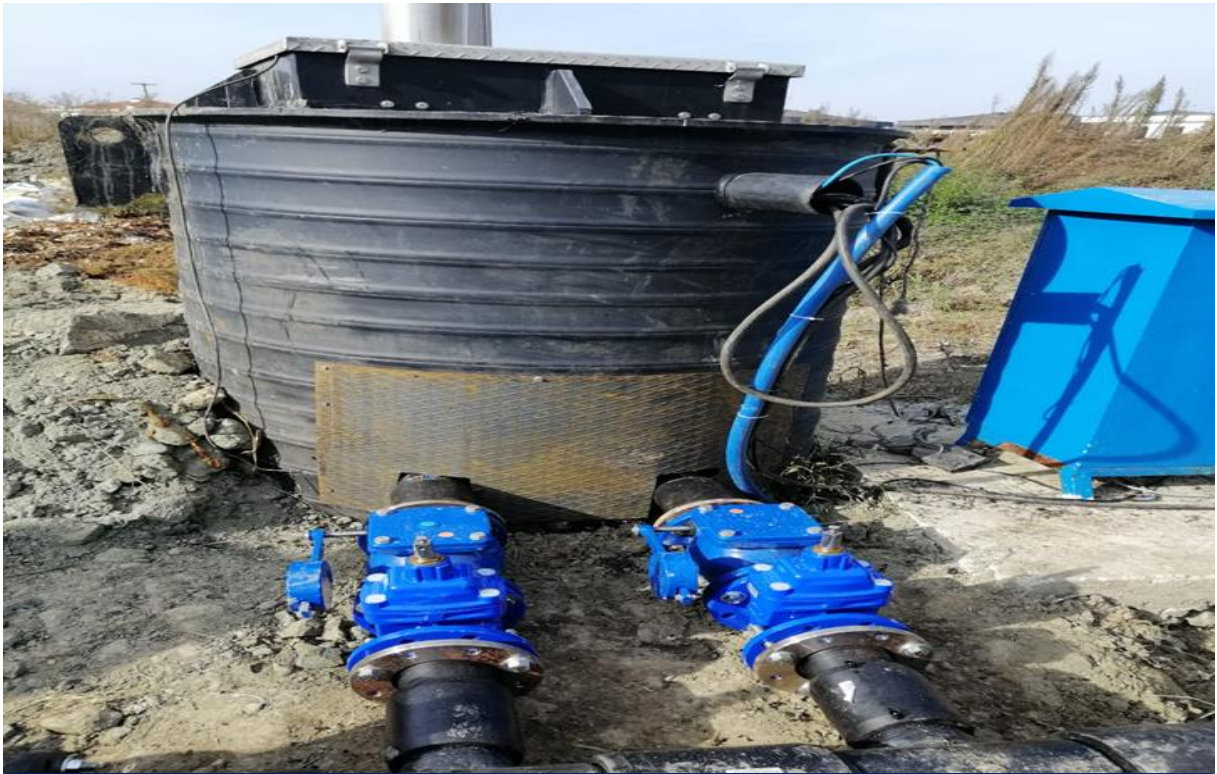
Altınordu Doğa Koleji Paket Atık Su Terfi Merkezi
