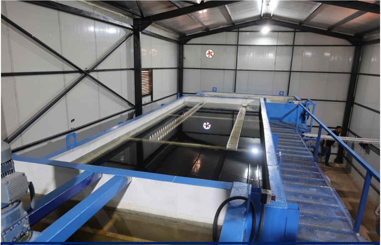
Alankent İçme Suyu Arıtma Tesisi
