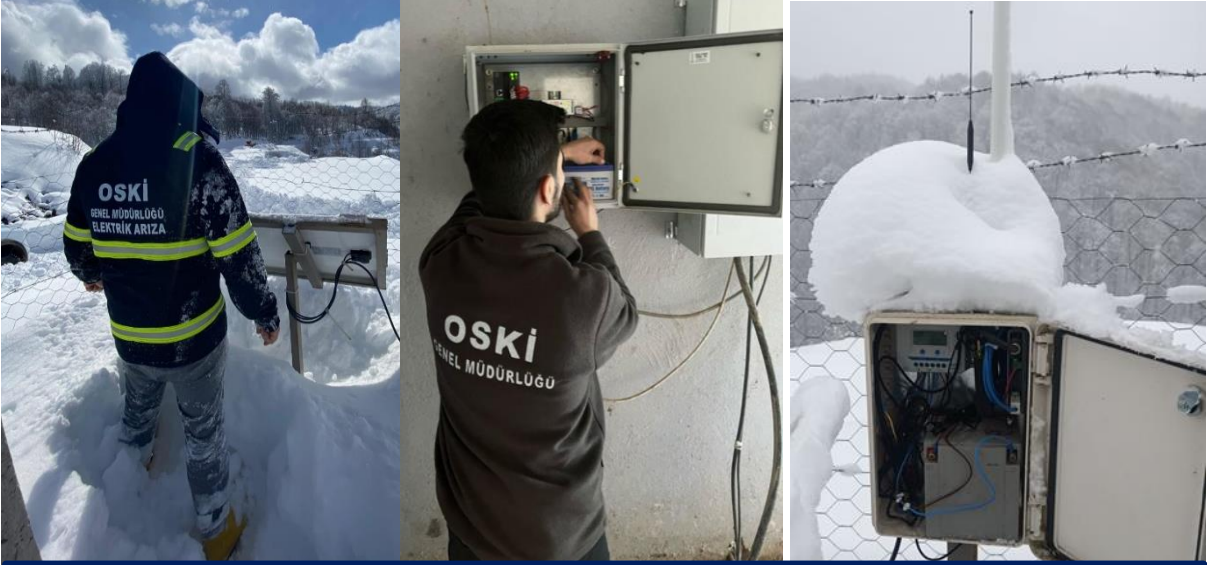
SCADA Arızalarının Giderilmesi
