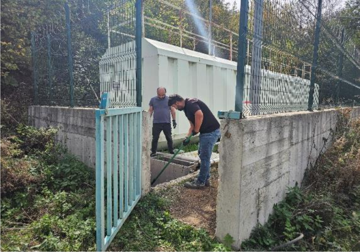
Mesudiye Yeşilce Paket Atık Su Arıtma Tesisi
