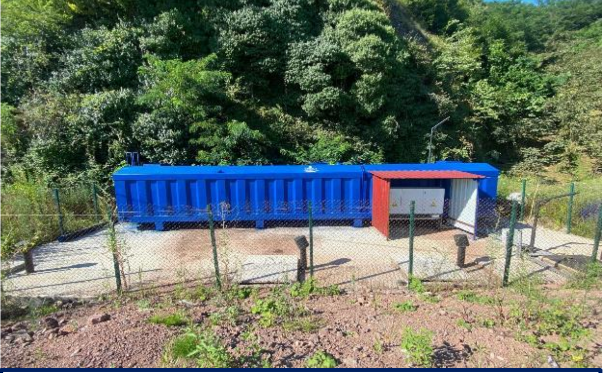
Ulubey Paket Atık Su Arıtma Tesisi
