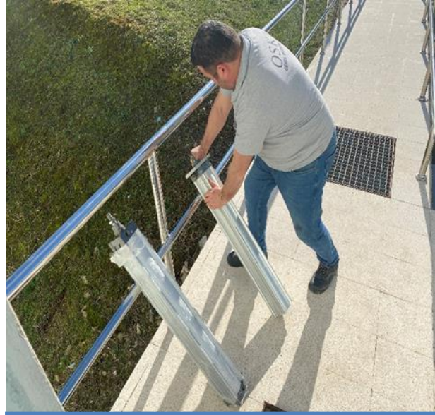
FİLTRE PENSTOCK KAPAK PİSTON DEĞİŞİMİ
